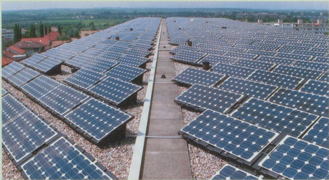
(Foto: ADEV Solarstrom AG, Liestal)
