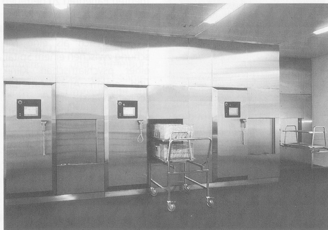
Zentralsterilisation im Kantonsspital Baden/Schweiz.
