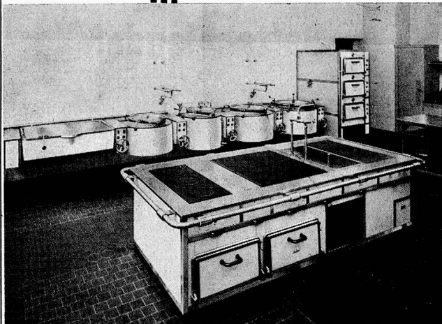
Elektrische Küchen-Anlage im Mütter- und Säuglingsheim Inselhof, Zürich
