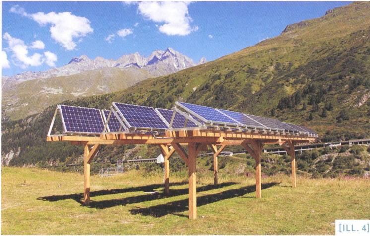
[ILL. 4] Installation au sol permettant de réaliser des essais / Pilotanlage an Land / Installazione a terra per la realizzazione di test (Source : Romande Énergie)
