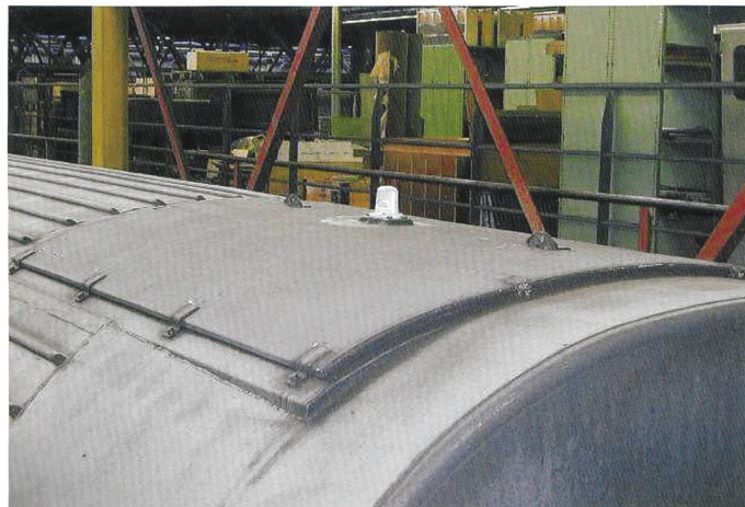
Bild 3. Aussenantenne am EW-IV.
