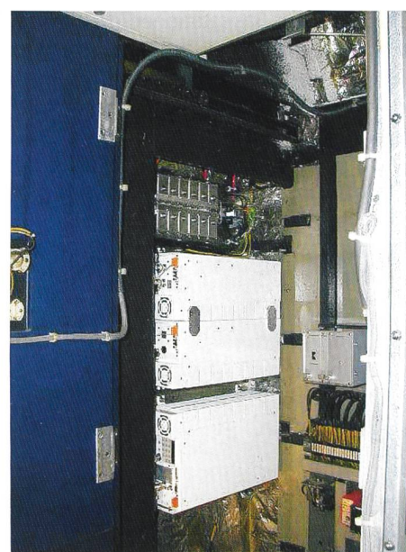
Bild 4. Gesamtes System (Türabdeckung offen) im EW-IV mit Notch-Filter (oben), Booster (Mitte) und Repeater (unten).
