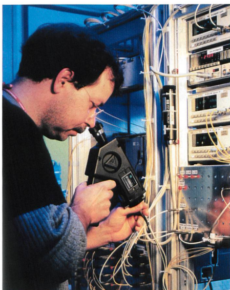
Letzte Vorbereitung zum DWDM-Systemtestlauf (Wellenmultiplex-System) in den Bell Labs von Lucent in Nürnberg.
