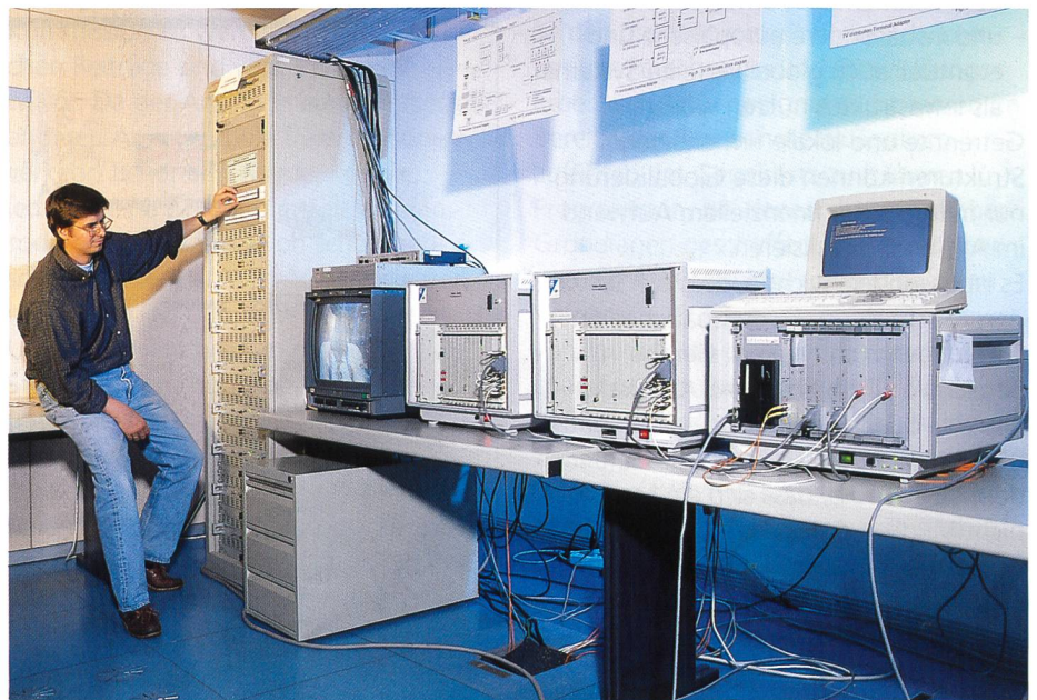
Bild 5. Blick in die Forschungsräume des Swiss National Host. Einspeisung der TV-Programme in die ATM-Plattform. TV-Programme werden via Satelliten-Kommunikations-Empfangseinrichtungen via Video-Coder dem ATM-Terminal-Adapter (Sender) zugespiesen (Bilder 5 bis 7: H.R. Bramaz)
