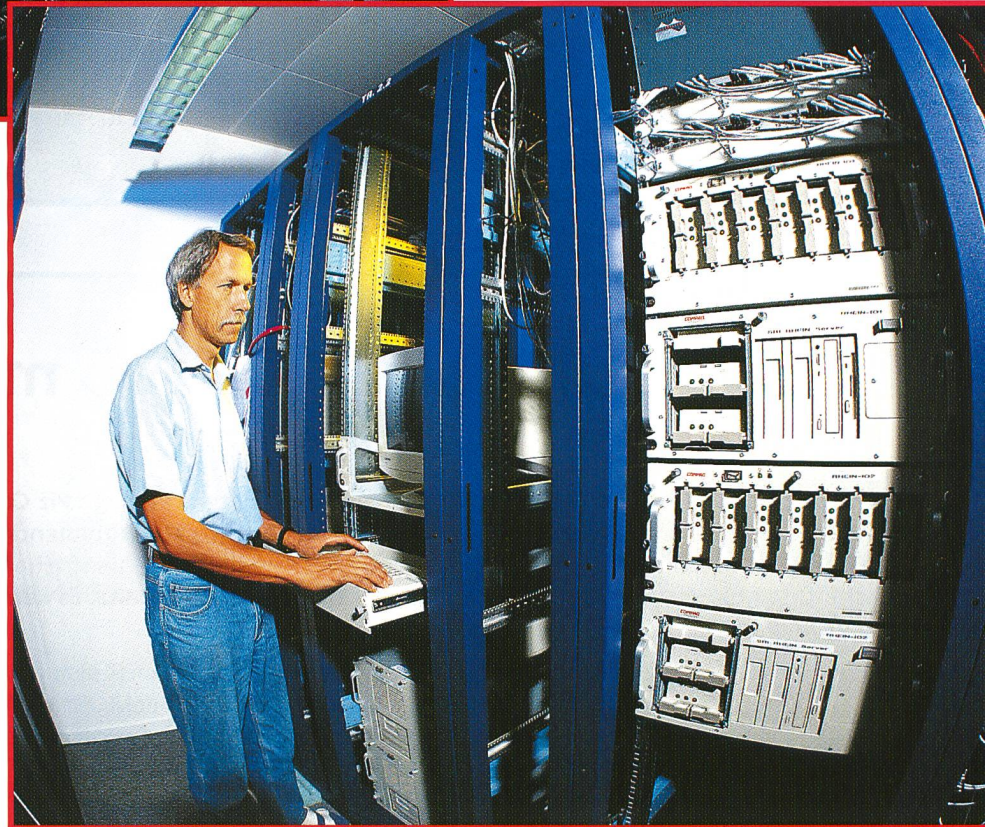
► Bild 8. Aufzeichnungsracks (Bilder H. R. Bramaz, Zürich).
