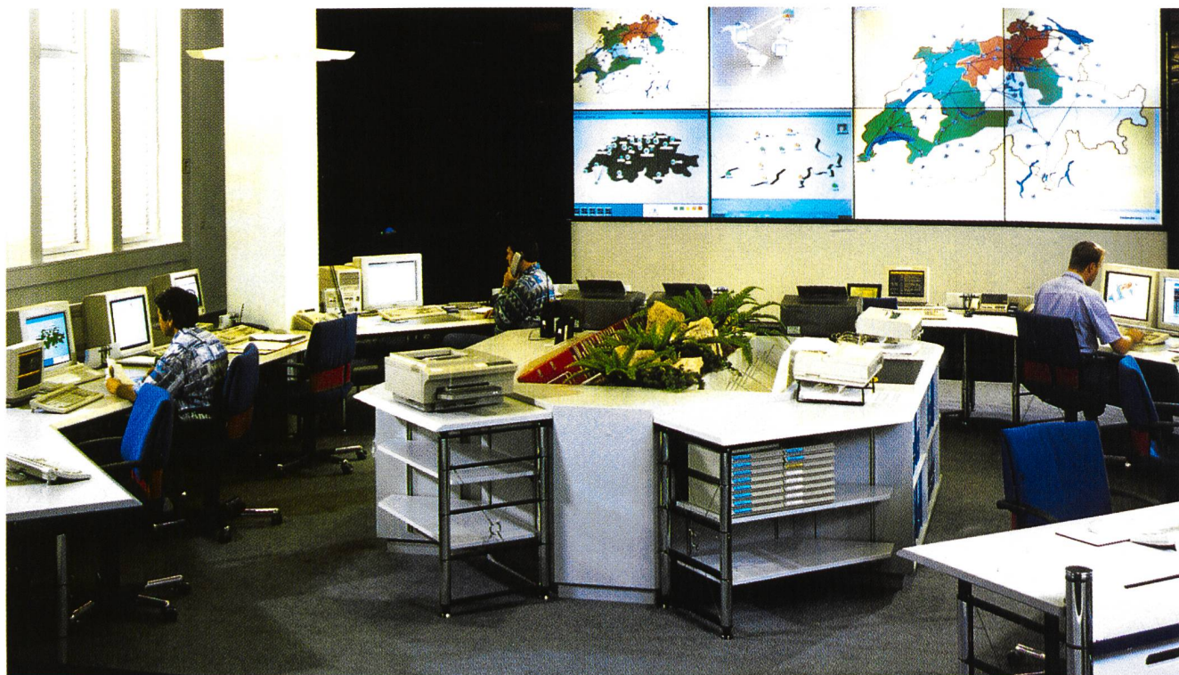
Bild 5. Das 1994 eröffnete zentralisierte Netzkontrollzentrum in Thun ist für die Sicherstellung des Netzbetriebs während 24 Stunden aktiv.
