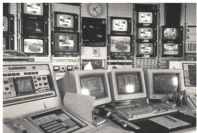
Fig. 17 Neuer Schaltraum Hauptbedienstellen (HBS) mit Monitorwand
