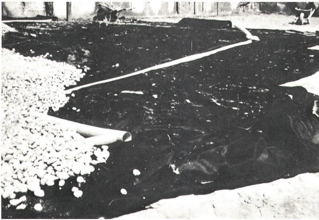
Fig. 9 Auf dem schwarzen Filtergewebe sind die Sickerrohre verlegt. Darüber ist auf der linken Seite der Sickerbeton sichtbar
