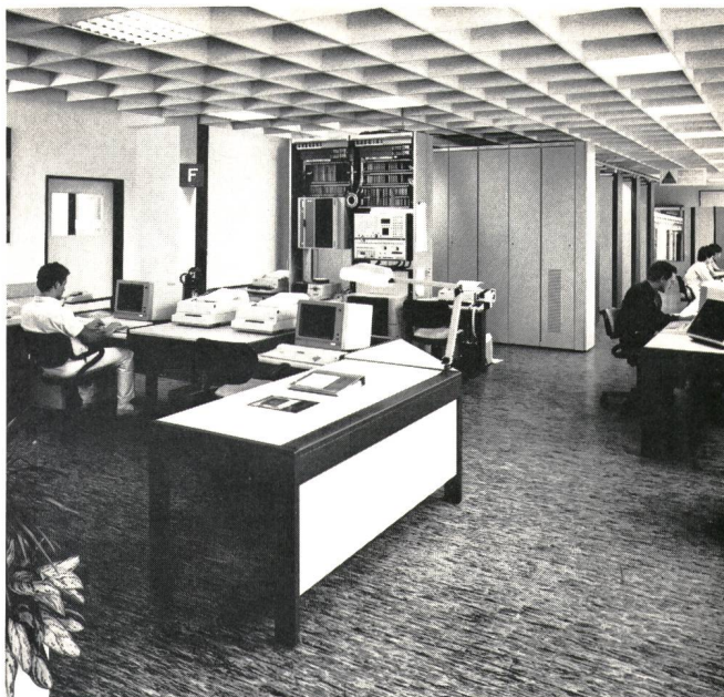
Fig. 10 Vista degli impianti EWSD utilizzati per le prove di integrazione
