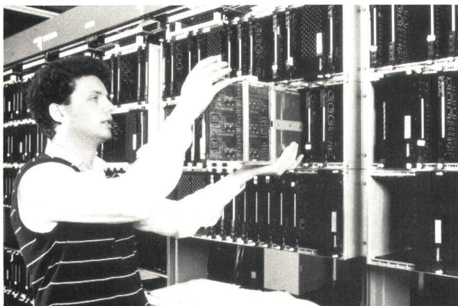
Fig. 5 Ansicht einer Gestellreihe – Vue d'une rangée de bâtis
