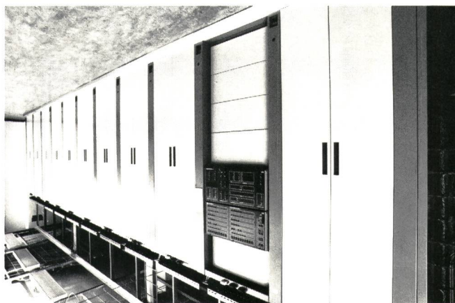
Fig. 4 PC-85-Anschlusszentrale, wird auf PC 88 mit systemintegrierter Taxdatenregistrierung ausgebaut – Central de raccordement PC 85. Sera modifié en PC 88 avec dispositif d'enregistrement des données de taxation intégré au système
