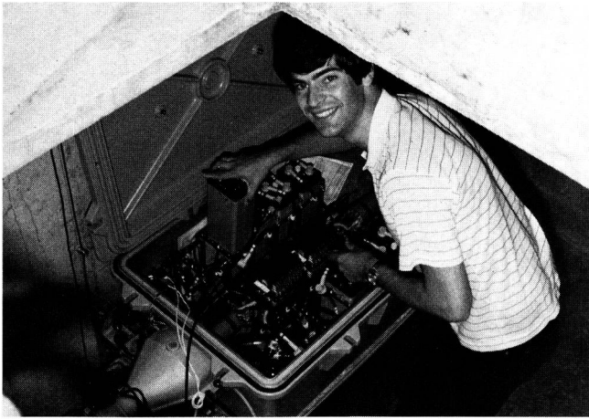
Fig. 3 Unterirdischer Zwischenverstärkerkasten – Caisson souterrain contenant des régénérateurs
