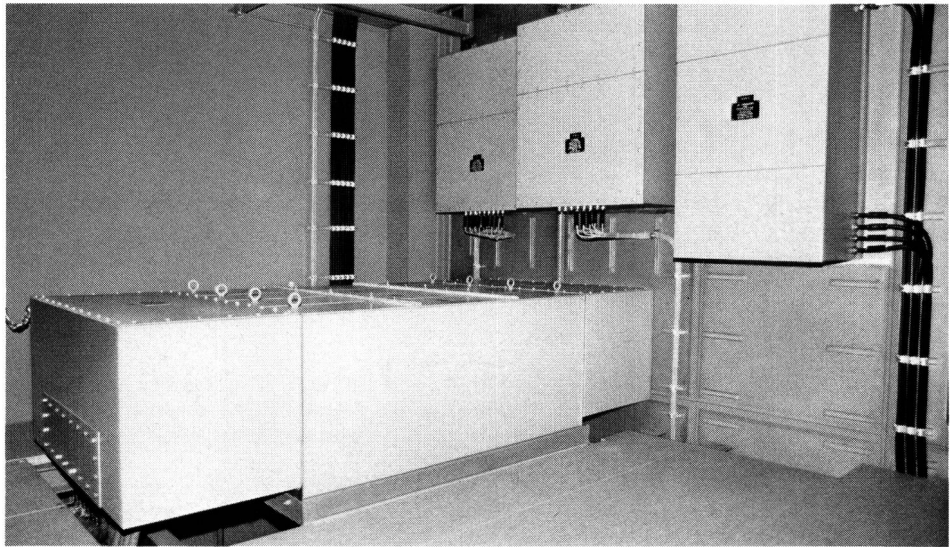
Ein Beispiel für die erfolgreiche Zusammenarbeit der Abteilungen von Elektro-Winkler: Planung und Installation einer EMP-Anlage.
