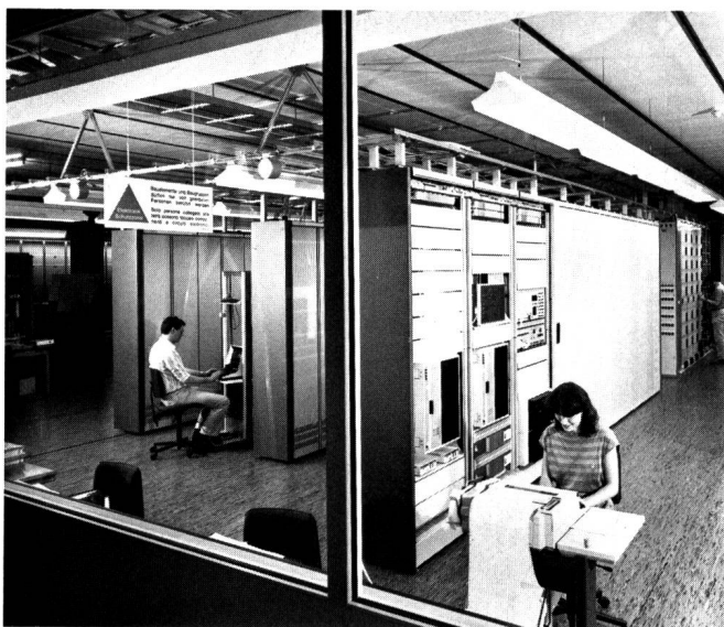
Fig. 3 Blick in den Zentralenraum der interkontinentalen EWSD-Zentrale Zürich-Herdern der Schweizerischen PTT – Coup d'œil sur les rangées de bâtis du central intercontinental des PTT suisses de Zurich-Herdern
