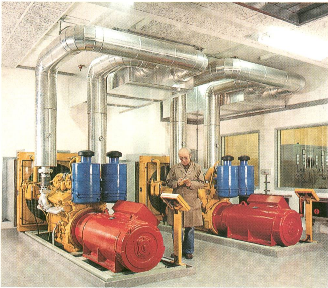
Notstromgruppen zu je 270 kW – Groupes de secours d'une puissance de 270 kW chacun
