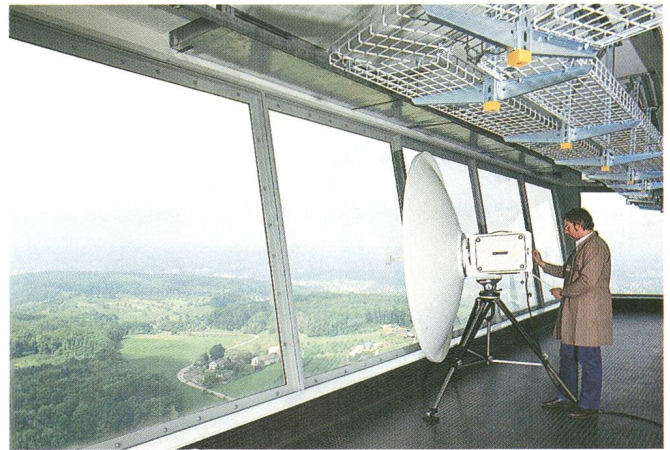
Raum im obersten Turmausbau (+ 138 m) für temporäre und Reportage-Richtstrahlverbindungen – Local dans l'élément saillant le plus élevé de la tour (+ 138 m) pour liaisons à faisceaux hertziens temporaires et de reportage
