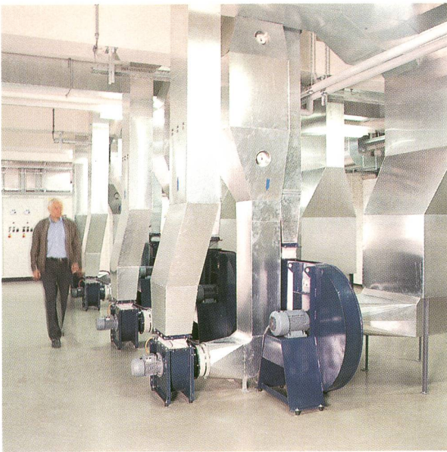
Ventilationsanlage für die Fernsehsender – Installation de ventilation pour les émetteurs de télévision
