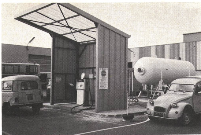
Fig. 5 Gastankstelle mit flüssiggasbetriebenen Fahrzeugen der französischen PTT in Lyon — Colonne de distribution de gaz avec véhicules exploités au gaz des PTT français
