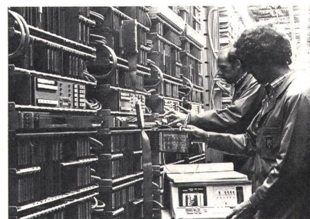
Testarbeiten an den mikrocomputer-gesteuerten elektronischen Multiregistern
