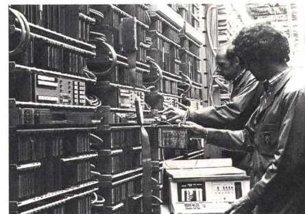
Testarbeiten an den mikrocomputer-gesteuerten elektronischen Multiregistern
