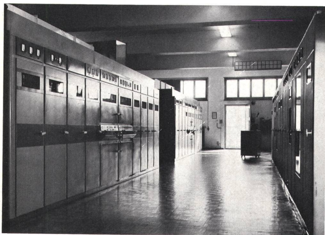
Kurzwellensender Schwarzenburg: Rundspruchsendersaal — Emetteur à ondes courtes de Schwarzenburg: Salle des émetteurs radiophoniques
