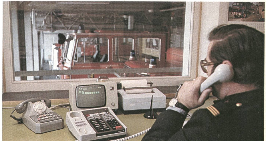
Kommandostelle einer Mannschaftsalarmanlage — Posto di comando di un impianto d'allarme per squadre
