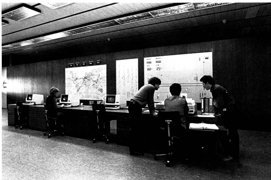
Anzeige- und Bedienungselemente am zentralen Überwachungstableau
