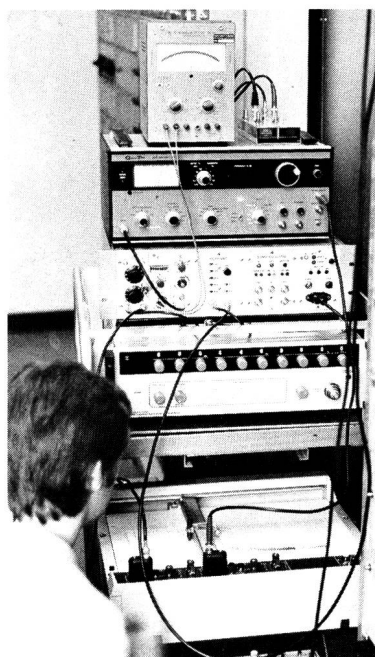
Fig. 9 Messaufbau zur Bestimmung des Phasenrauschens der FDM-Abgänge einer Grundfrequenzversorgung — Dispositif de mesure servant à déterminer le bruit de phase des sorties MRF d'une baie génératrice de fréquences de base
