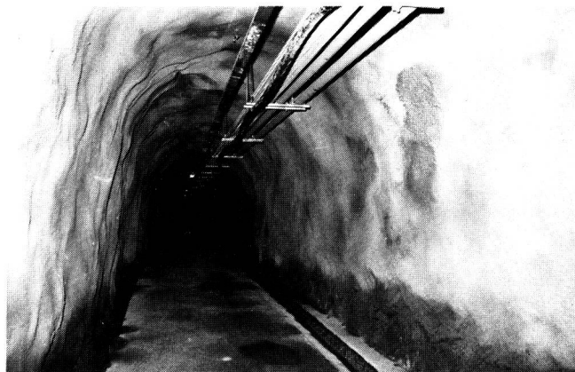
Fig. 7 Blick in den für die Fahrer normalerweise unzugänglichen Sicherheitsstollen — Aperçu de la galerie de sécurité habituellement inaccessible aux conducteurs
