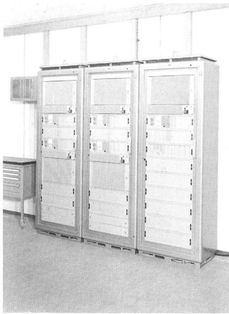
Fig. 1 Ortsfeste Sende- und Empfangsstation für fünf Sprechkanäle – Station émettrice-réceptrice fixe équipée de cinq canaux de conversation
