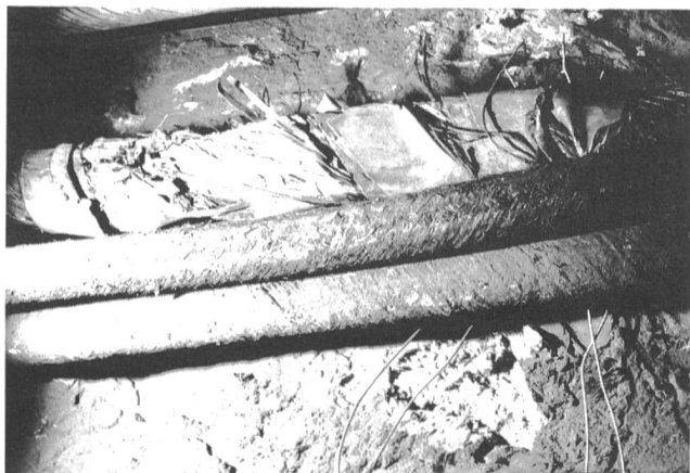
Fig. 2 Kabelbeschädigung im Bahntunnel — Danneggiamento dei cavi nella galleria ferroviaria
