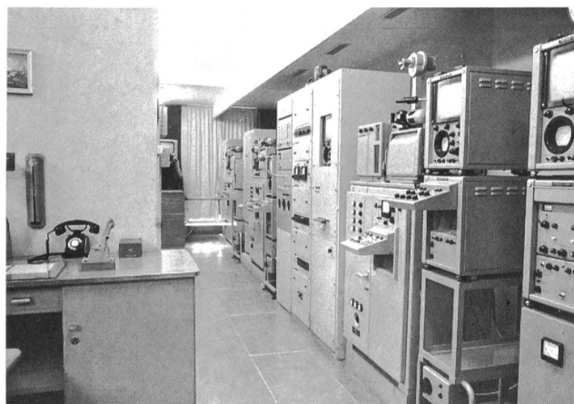
Fig. 5 Salle des équipements centralisés avec une rangée de télécinémas à tube Vidicon — Apparateraum mit Vidicon-Filmabtastern im zentralisierten Betrieb
