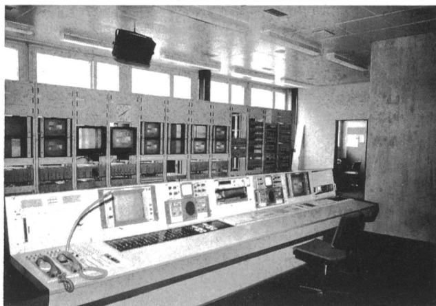
Fig. 11 Centre de commutation du nouveau studio de Lugano-Comano — Schaltzentrum im neuen Fernsehkomplex Lugano-Comano
