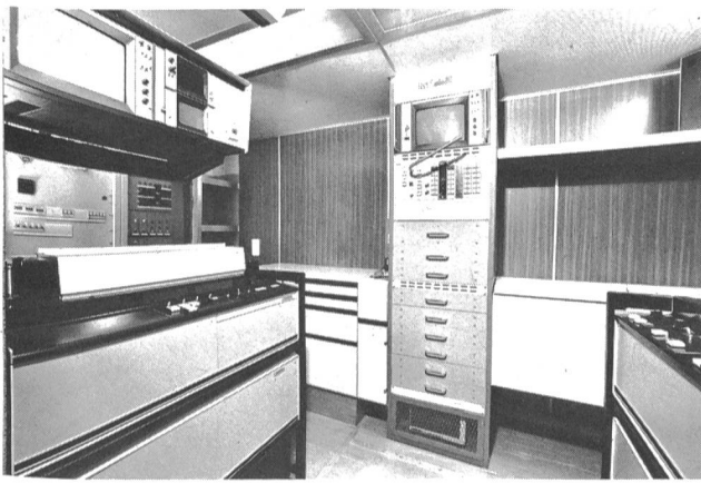
Fig. 5 Vorderer Teil des Apparateräumes, von der Eingangstüre her gesehen – Partie avant du local des appareils, vue de la porte d'entrée
