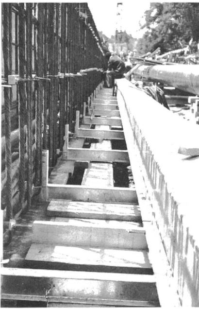
Fig. 7 Die Kabel sind endgültig in den Blechkanal eingelegt. Die Verankerungen der Trägerelemente werden in die Armierung des Brückenlängsträgers einbezogen
