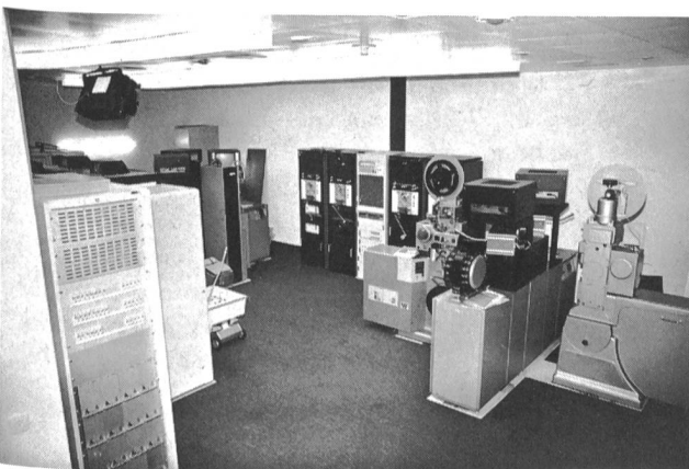
Fig. 12 Apparateraum einer Senderegie — Sala apparecchi di una regia di continuità
