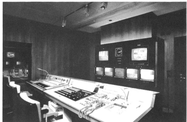
Fig. 10 Senderegiepult. Links Ton-, rechts Bildteil — Banco della regia di continuità. A sinistra settore audio, a destra settore video
