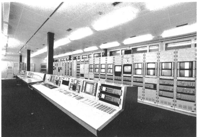
Fig. 4 Schaltzentrum. Vorne Bild-, hinten Tonteil — Centro di commutazione. Davanti il settore video, dietro il settore audio
