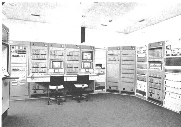
Fig. 18 Apparateraum des Produktionsstudios — Sala apparecchi dello studio di produzione
