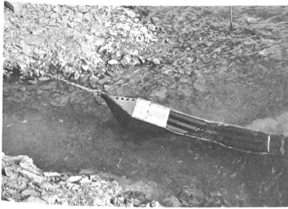
Fig. 3 Rohrschlitten beim Ausfahren
