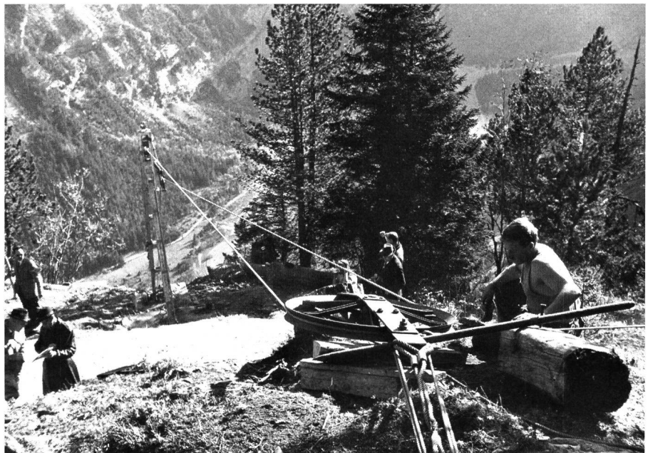
Montage eines Luftkabels in den Bergen Montage d'un câble aérien dans une région montagneuse Installation of an aerial cable in a mountainous region
