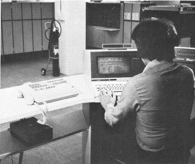
Fig. 8 Abfrage- und Ueberwachungseinrichtung für Datenleitungen: links der Abfrage- und Ueberwachungsapparat, darunter das Textansagegerät – Dispositif d'interrogation et de surveillance pour lignes de données; à gauche, l'appareil d'interrogation et de surveillance, au-dessous, la machine pour textes enregistrés
