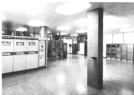
Fig. 1 Teilansicht der Senderanlagen in der Regionalstation Celerina
