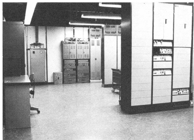
Fig. 7 Der Richtstrahlraum Nord. Er beherbergt die Ausrüstungen für Verbindungen im Bereich Nordost-West
