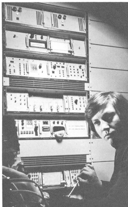
Fig. 1 Terminal pour le système numérique STC de 120 Mbit/s installé sur une liaison de télécommunications interurbaine dans le sud de l'Angleterre.
