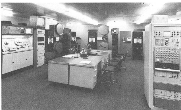
Fig. 9 Vue partielle de la salle des appareils de la continuité dans laquelle on distingue un magnétoscope et deux télécinémas – Teilansicht des Ablauf-Apparateriums in dem ein Bildaufzeichnungsgerät und zwei Filmabtaster zu erkennen sind
