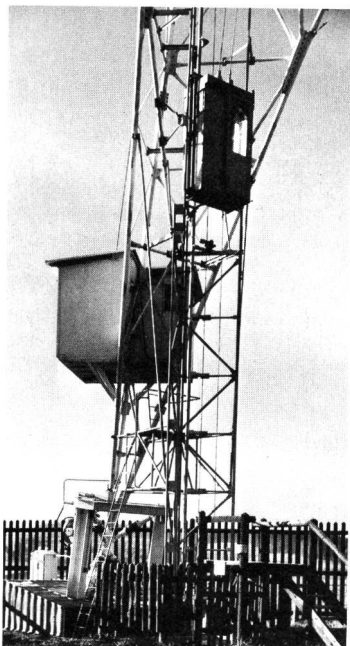
Fig. 5 Betriebsaufzug eines Antennenmastes
