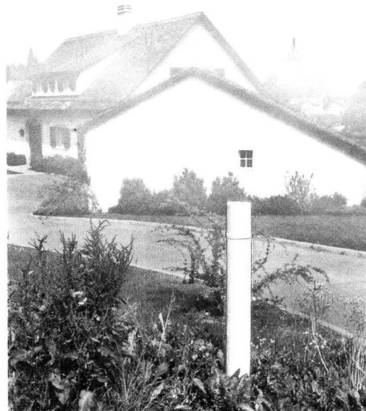
Fig. 8 Kabelverteilsäule – Colonne de distribution de câbles
