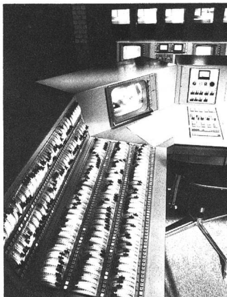
Fig. 5 Lichtregiepult des Studios 1, im Vordergrund die Schaltorgane der elektronischen Speicheranlage
