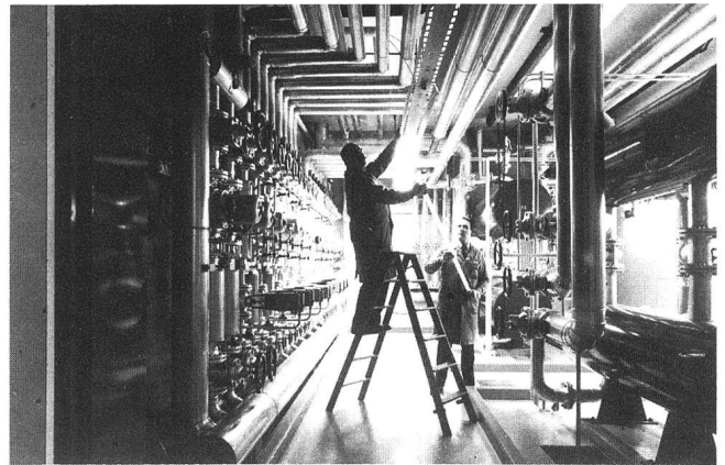
Fig. 5 Heizungsunterstation, rechts Wärmeumformer, links Wärmeverteilstation – Sous-station de chauffage, à droite l'échangeur de chaleur, à gauche la station de distribution calorifique
