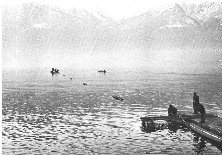
Fig. 6 Posa del cavo da Muralto in direzione di Vira. I galleggianti sono ben visibili
