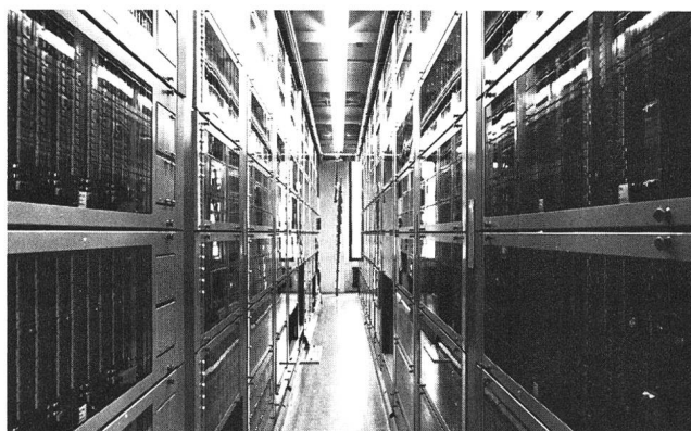
Fig. 2 Blick in die Gestellreihen der Relais und Wähleinrichtungen des neuen Fernamtes
