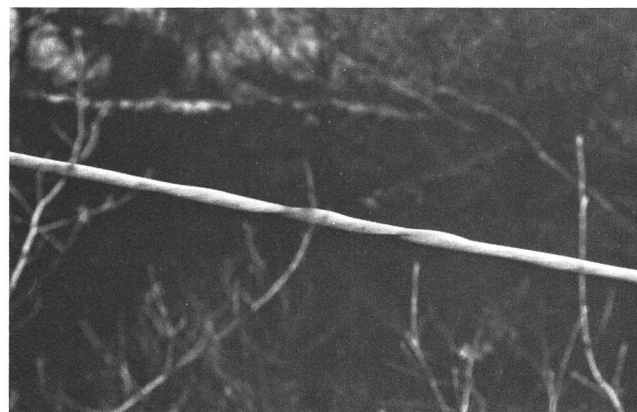
Fig. 9 Unregelmässige Wirbelbildung an einem selbsttragenden Kabel – Déformations irrégulières sur un câble autoporteur
