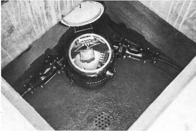
Fig. 6a Zwischenverstärker offen, in einem Schacht montiert – Amplificatore intermedio aperto, montato in una cameretta
