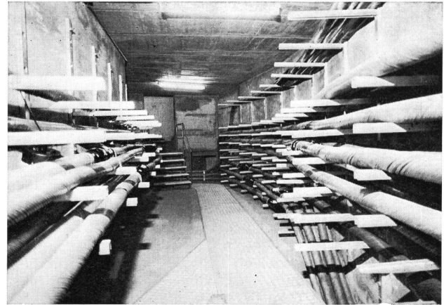
Fig. 2 Berns unbekanntes Unterwelt: Blick in einen der Kabelstollen mit grossen und kleineren Orts-, Bezirks- und Fernkabeln
