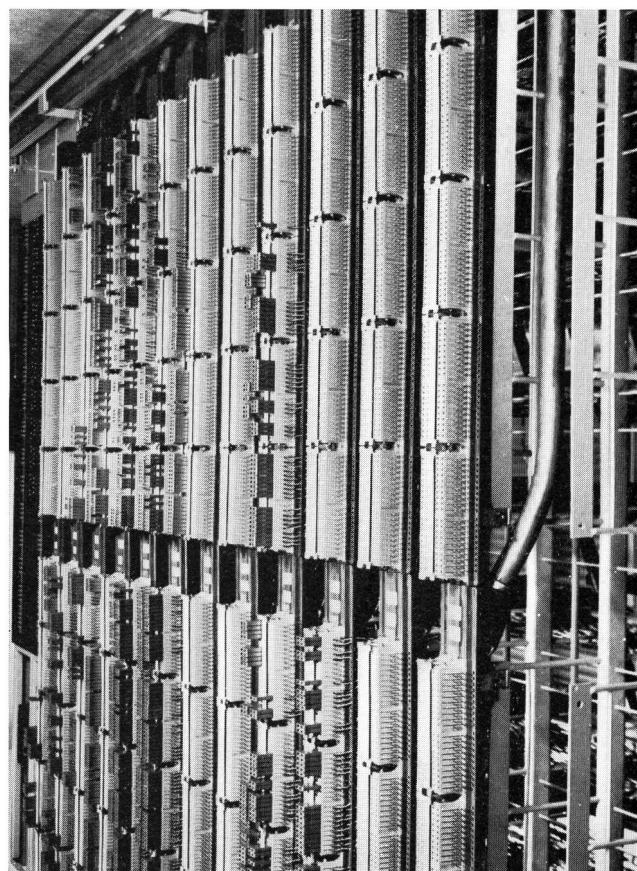
Fig. 9 Hauptverteiler mit Teilnehmerkabelendverschlüssen Répartiteur principal avec terminaisons pour câbles d'abonnés
