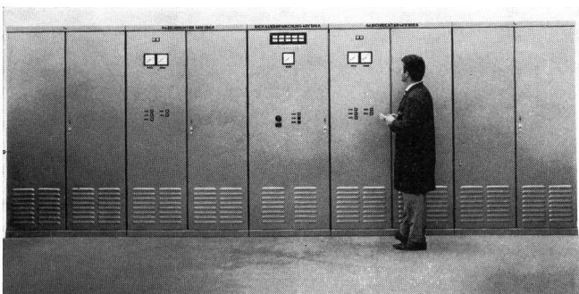
Fig. 10 Gleichstromanlage 48 V, Typ 600 A zur Speisung von Richtstrahl- anlagen
