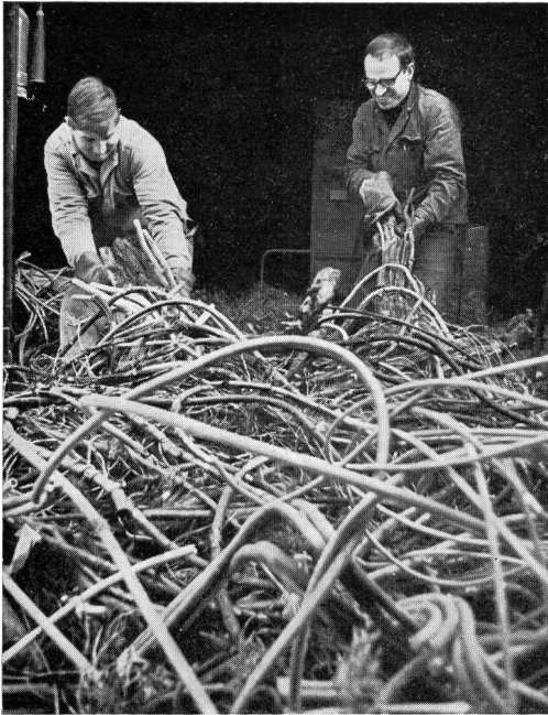
Fig. 5 Ausräumen beschädigter Kabel Enlèvement de câbles endommagés
