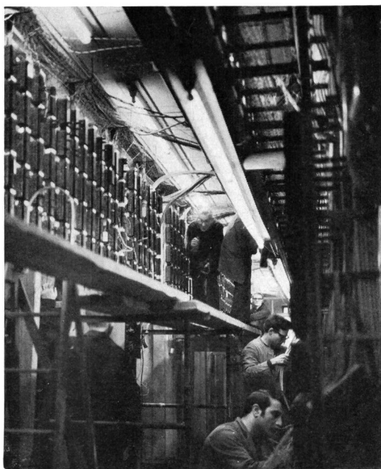
Fig. 13 Provisorischer Hauptverteiler im Keller, bereit zur Aufnahme der Überführungen Répartiteur principal provisoire monté à la cave, prêt à recevoir les renvois
